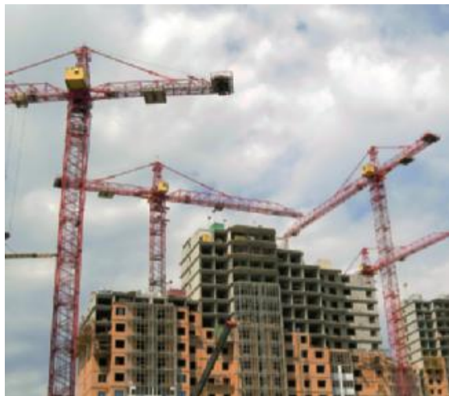
Gru utilizzate per la costruzione di alcuni edifici in un cantiere edile
